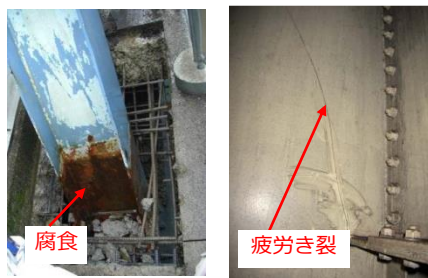
鋼橋における劣化・損傷
